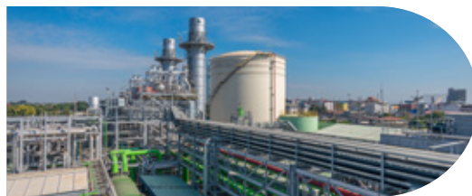
ПРОИЗВОДСТВО ЭЛЕКТРОЭНЕРГИИ И ОЧИСТКА ВОДЫ
