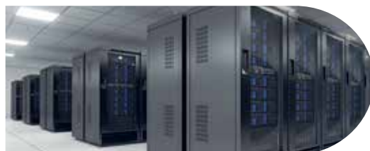
GRANDI DATA CENTER
